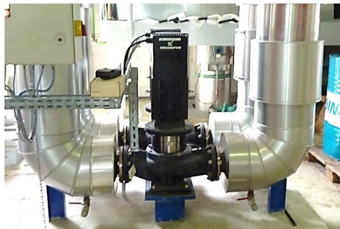
Abbildung 4-9 Hochenergieeffizienz-Normpumpe am Standort „HKW Nord“
